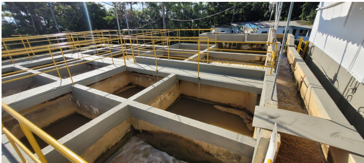
Vista das etapas de floculação da ETA I.
