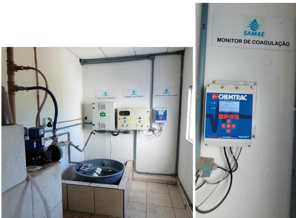
Vista do monitoramento de coagulação da ETA I.
