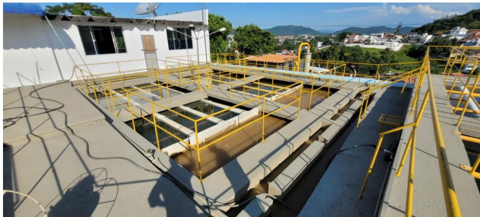
Vista das etapas da ETA I.
