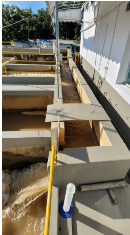
Vista da entrada nos floculadores da ETA I.
