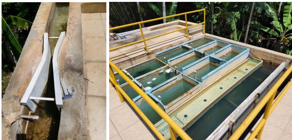
Vista da calha parshall e etapa e floculação da ETA IV.
