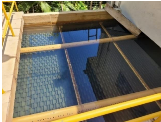
Vista da etapa de decantação da ETA IV.
