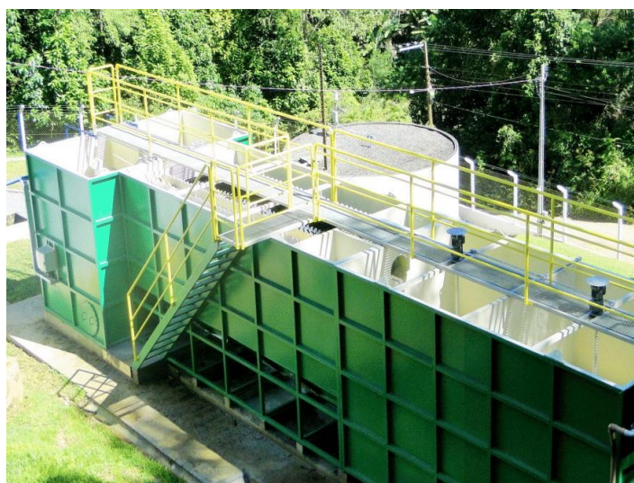
Vista aérea da ETA V.
