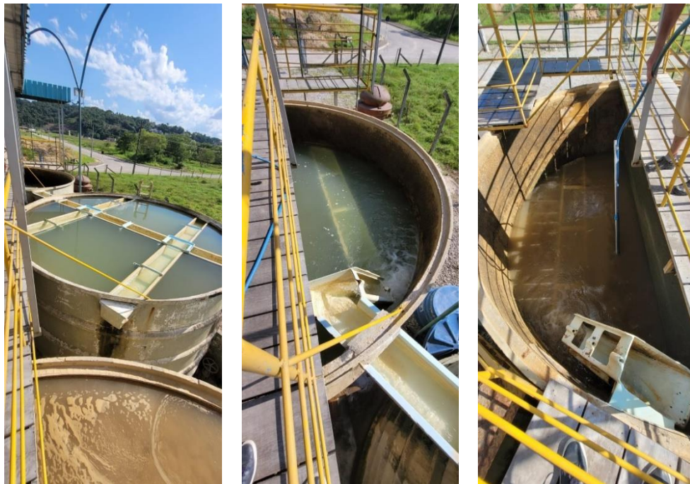
Vista das etapas de decantação e floculação e filtração da ETA II.
