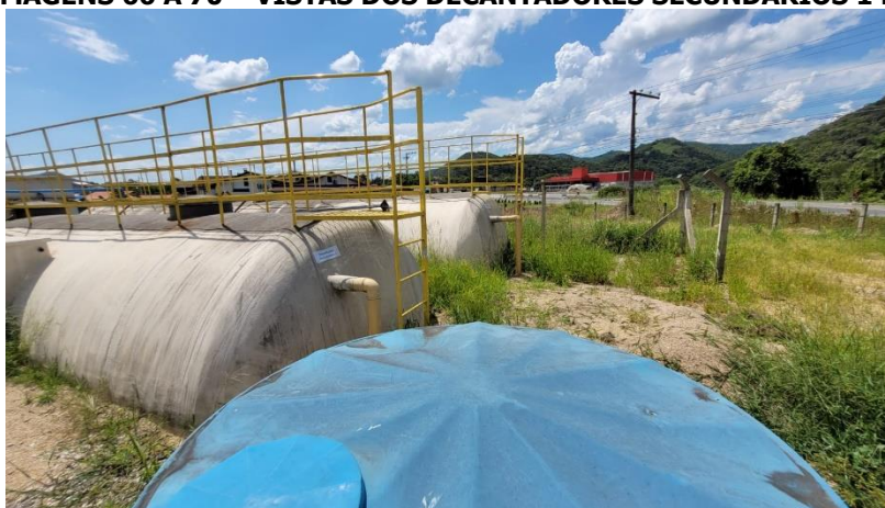
IMAGENS 66 A 70 – VISTAS DOS DECANTADORES SECUNDÁRIOS 1 E 2
