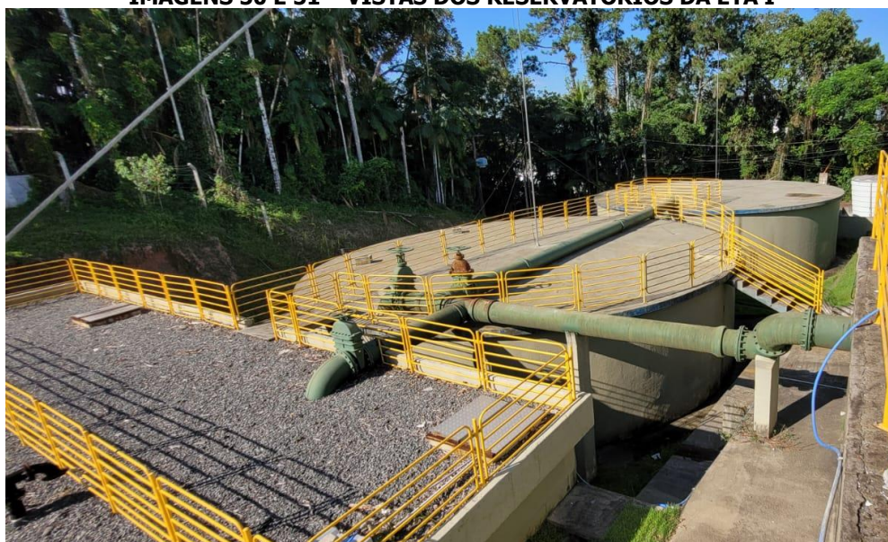
Vista dos reservatórios cilíndricos da ETA I.
