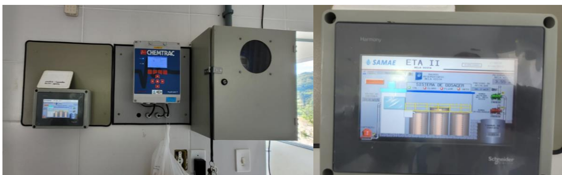
Vista do monitoramento do sistema de dosagem de cal, cloro, flúor e orto da ETA II.
