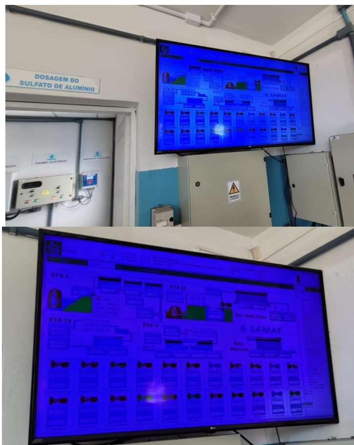
Vista do monitoramento das unidades do SAA junto à ETA I.
