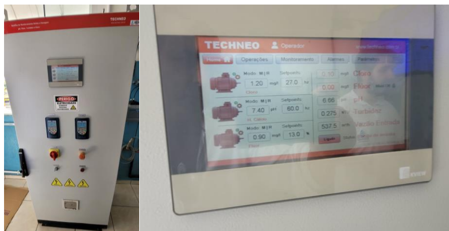
Vista do sistema de monitoramento online de cloro, flúor, pH, turbidez e vazão de entrada da ETA I.
