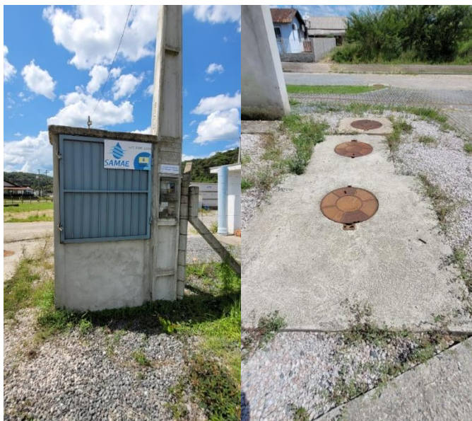
IMAGENS 64 E 65 – VISTAS DA ENTRADA DE ENERGIA ELÉTRICA E TAMPAS DE VISITA DA ETE MARGEM ESQUERDA
