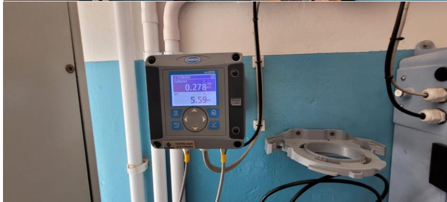
Vista do monitoramento do pH e turbidez da ETA I.
