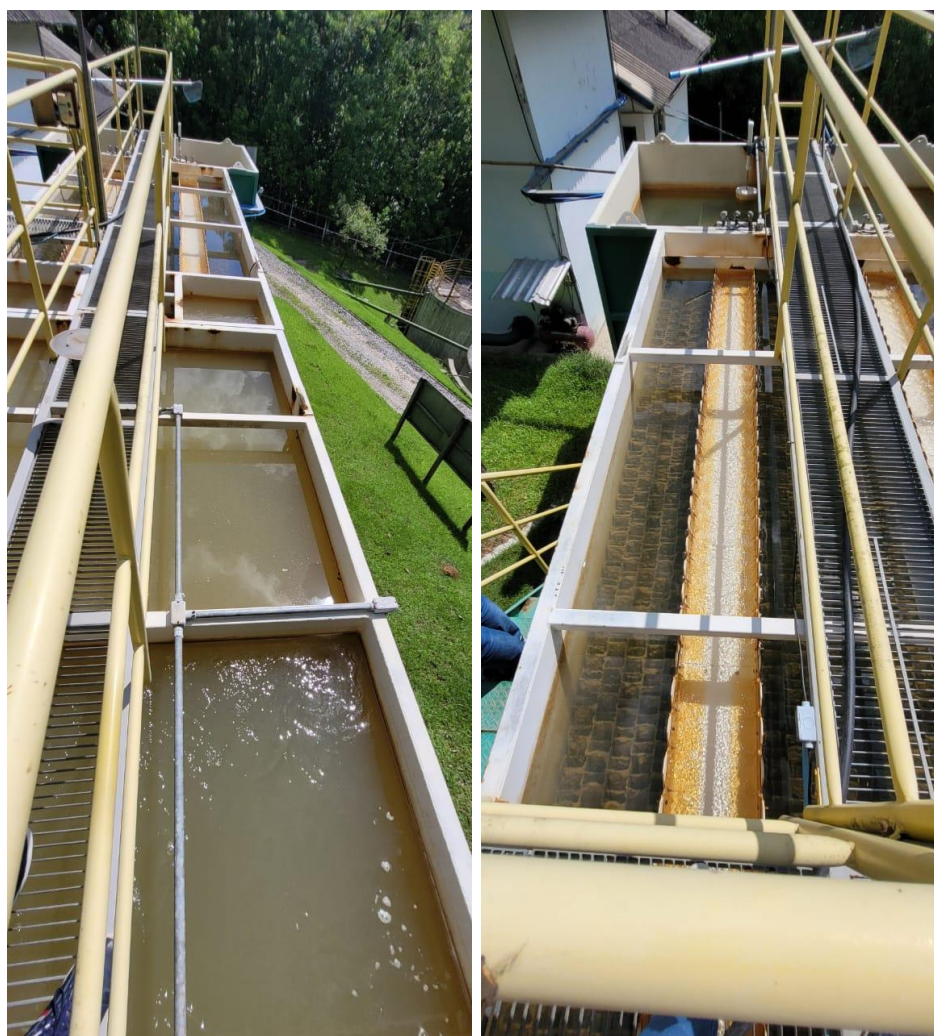
Vista da etapa de filtração e decantação da ETA V.
