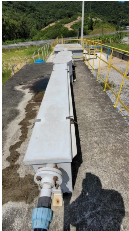
IMAGEM 72 – VISTA DA UNIDADE CONTENDO O CANAL DE ENTRADA, DESARENADOR, GRADEAMENTO E CALHA PARSHALL
