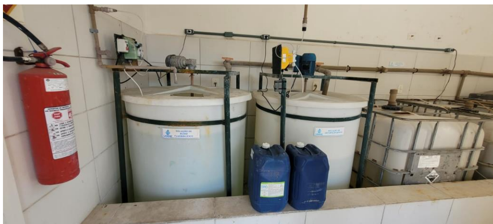
Vista do sistema de dosagem de cal, cloro, flúor e orto da ETA II.
