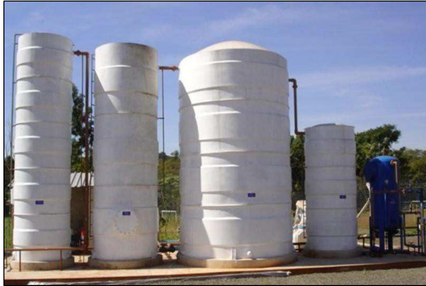
Figura 2.11 - Estação Compacta de Tratamento de Esgotos Sanitários.
