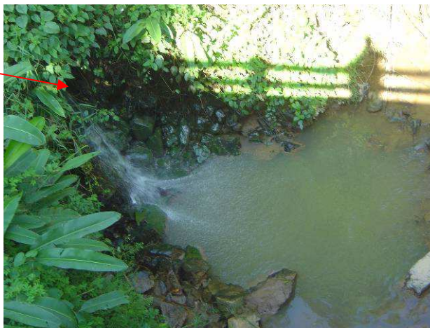
Figura 33 – Tubulação de drenagem lançando as águas pluviais e águas servidas do bairro Sete de Setembro num dos afluentes do rio Itajaí-Açu.
