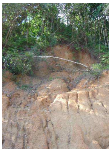
Figura 35 - Encosta erodida e que apresenta risco de deslizamento. Fonte: SAMUSA (2009).
