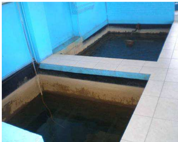
Figura 24 – Vista parcial das unidades filtrantes. Fonte: SAMUSA (2009).
