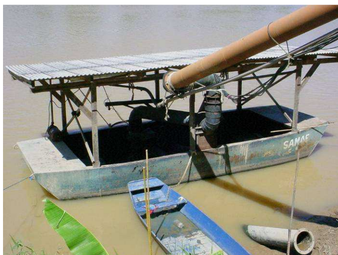
Figura 21 – Detalhe da lancha onde é feita a captação de água da ETA I. Fonte: SAMAE (2004)
