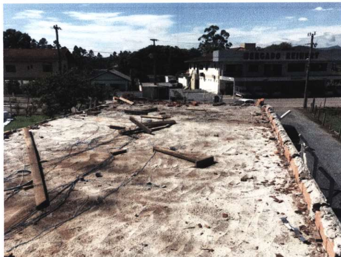
Foto 05 – Laje da edificação danificada – Fonte: Autor 2020
