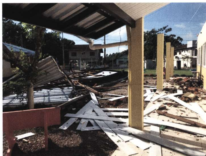
Foto 06 – Cobertura da passagem destruída e destroços espalhados pelo terreno – Fonte: Autor 2020
