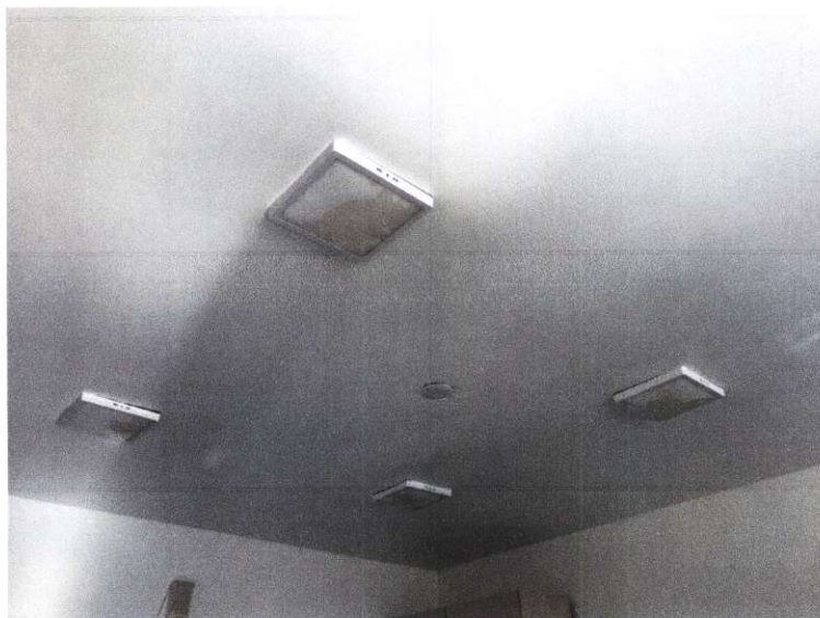
Foto 12 – Luminárias danificadas pela infiltração de água na laje de cobertura – Fonte: Autor 2020
