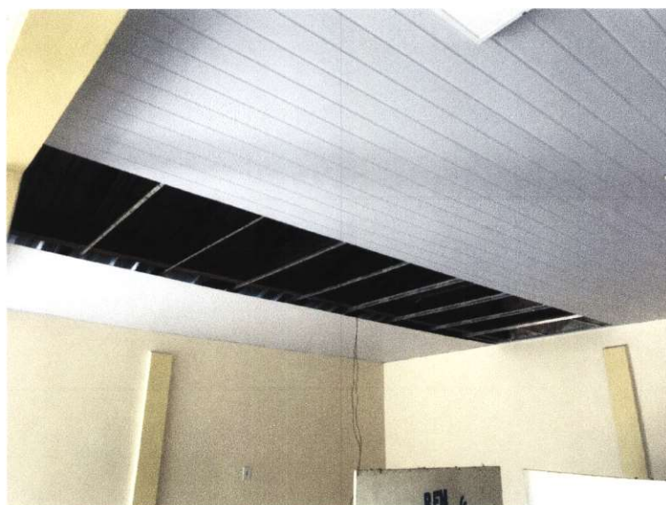
Foto 02 – Localização do forro danificado – Fonte: Autor 2020
