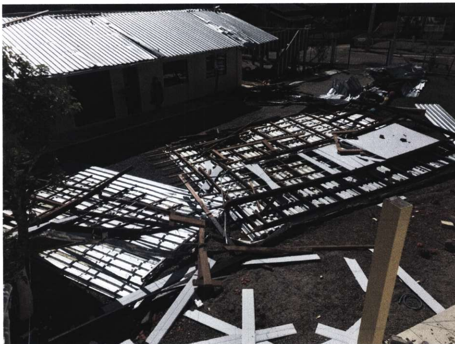
Foto 03 – Cobertura arrancada pelo vento – Fonte: Autor 2020
