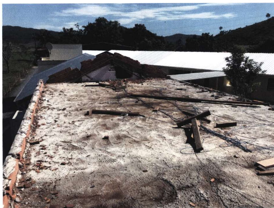
Foto 04 – Laje da edificação danificada, fiação elétrica exposta e danificada – Fonte: Autor 2020
