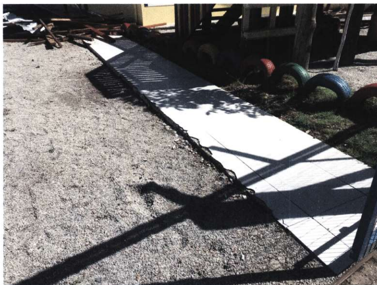
Foto 11 – Piso danificado – Fonte: Autor 2020
