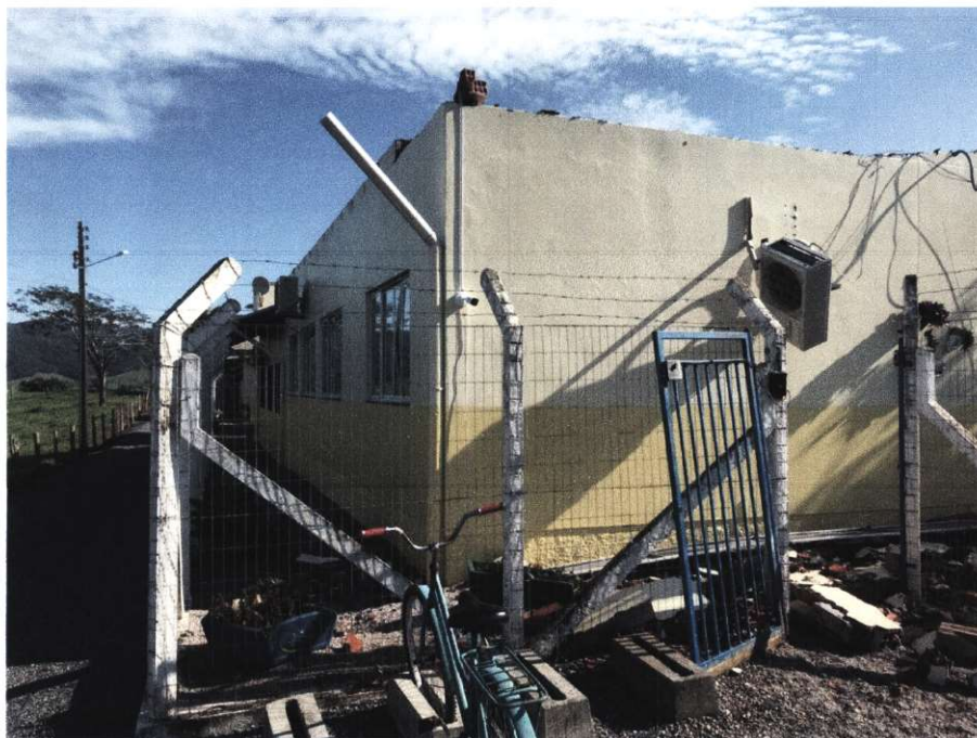
Foto 09 – Danos causados pela queda da alvenaria – Fonte: Autor 2020
