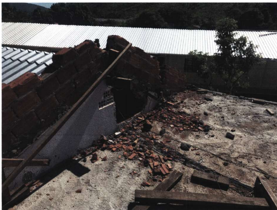
Foto 08 – Danos na alvenaria do telhado – Fonte: Autor 2020
